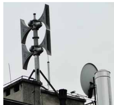
Syrena alarmowa zamontowana na Przedszkolu w Raciborzu
